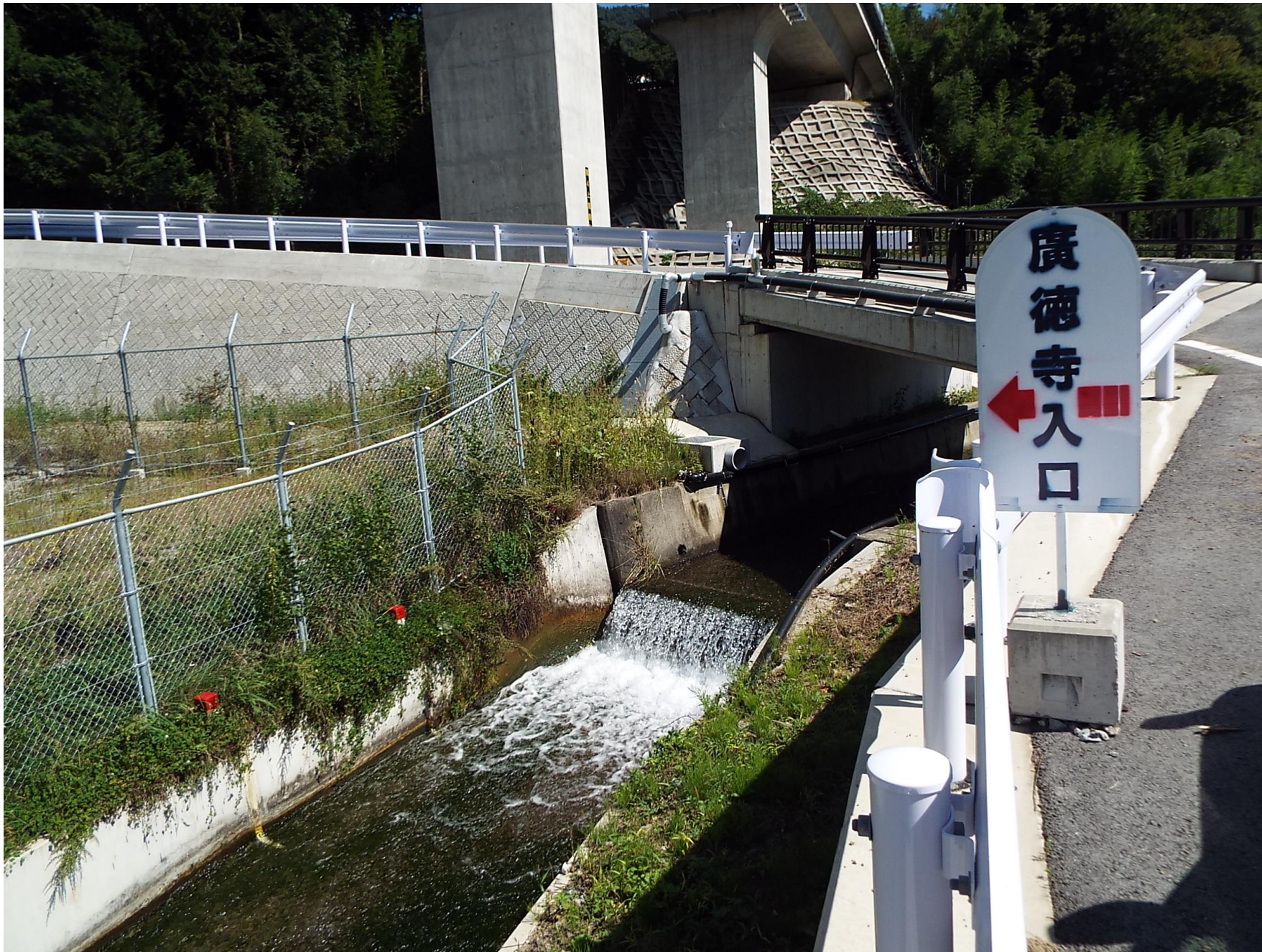
御坂トンネル西坑口での トンネル湧水 (30ton/min ≒8畳間を升にして1杯)
