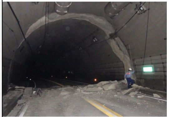
熊本地震で損壊した 西原村・俵山トンネル
