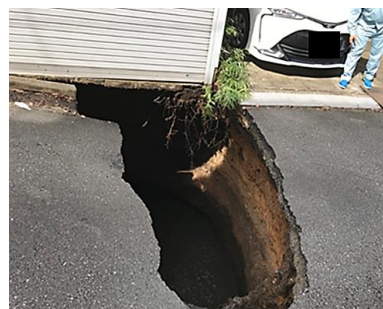
（2020 年 10 月調布市の陥没事故）
